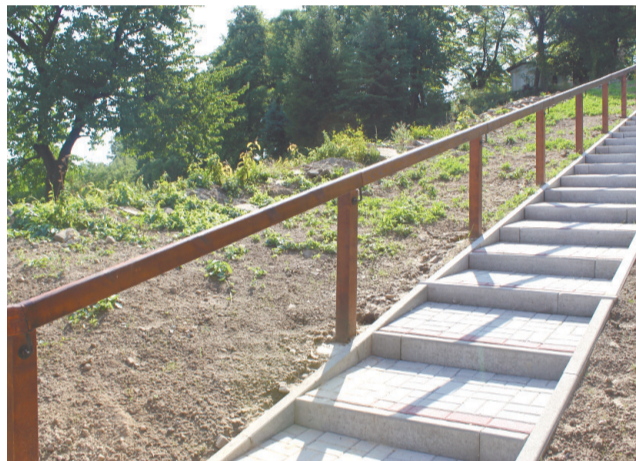
Budowa chodnika w Słupie - mieszkańcy mają bliżej do kościoła, sklepu i placu zabaw.
