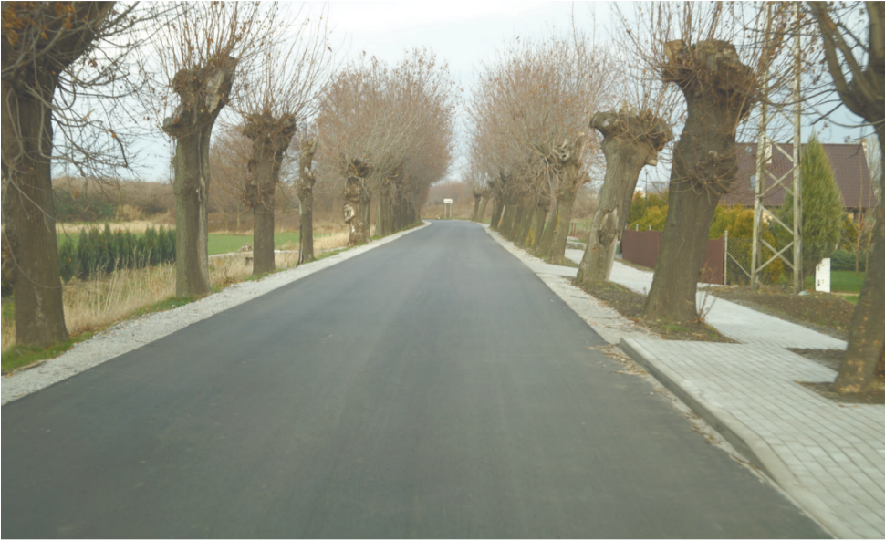
Nowa droga i chodnik w Piotrowicach wpłynęły na poprawę bezpieczeństwa i bez wątpienia wygląd tej miejscowości.
