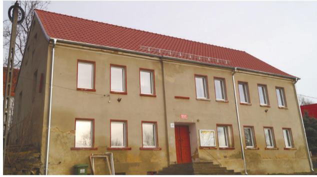
Nowy dach na świetlicy w Pomocnem zabezpiecza miejsce aktywności społeczności lokalnej przez warunkami atmosferycznymi.
